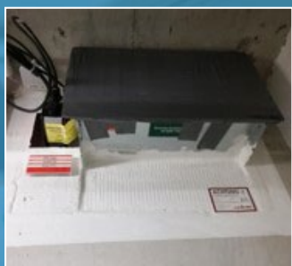
Abb. 1: Luftdichter Verschluss der Luftleitung
