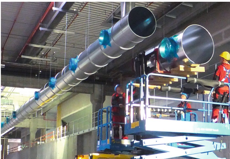
Für eine bestmögliche Energieeffizienz einer Lüftungsanlage sollten Luftleitungen so groß wie möglich ausgelegt werden. (Abb. Metu)
